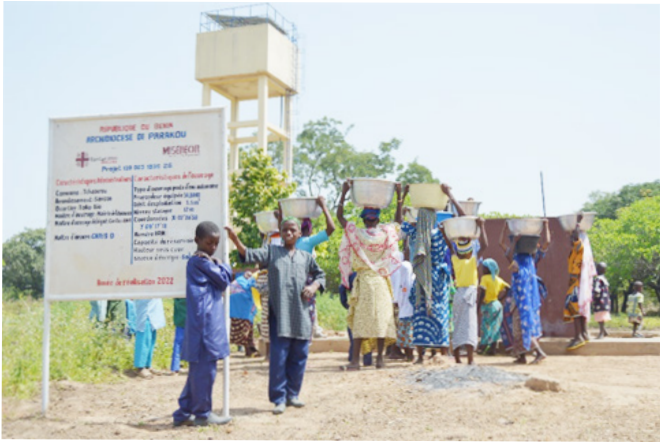
Poste d'eau autonome de Toko Bio, à château d'eau de 30m3 équipé de pompe et panneaux photovoltaïques
