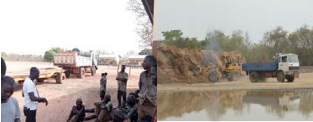
A gauche, sensibilisation de la population sur les travaux de réalisation du bassin de rétention d'eau de surface. A droite les travaux de déblai du site
